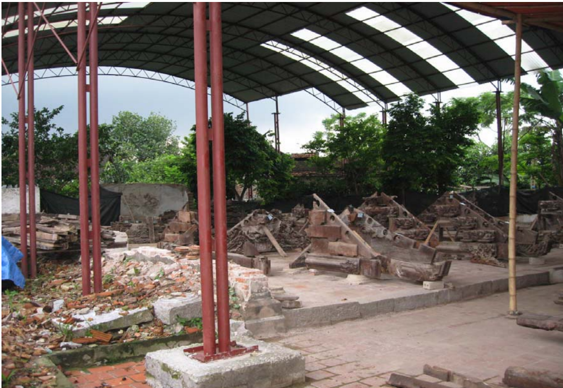
Công trường tu bổ đền Trần Khát Chân, Thanh Hóa (năm 2012) - Ảnh: Nguyễn Thức
